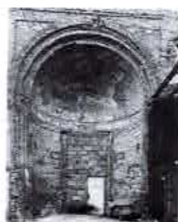
Die erhalten gebliebenen Reste der Ostwand des Israelitischen Tempels in der Poolstraße 12/13
